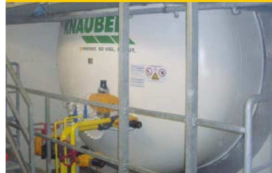
Behälter und Rohrleitungen sind lackiert. Die Sicherheitskennzeichen sowie das Logo des Betreibers wurden am Behälterboden angebracht.
