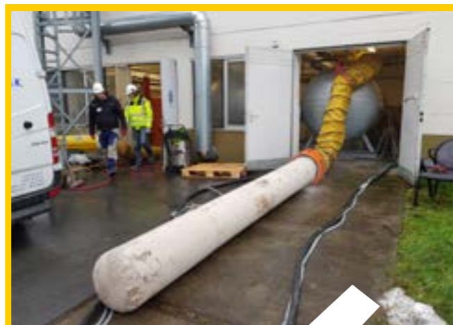
Die Entstaubungsanlage hat einen Durchmesser von 300mm und einen Staubsack von 6 Metern.
