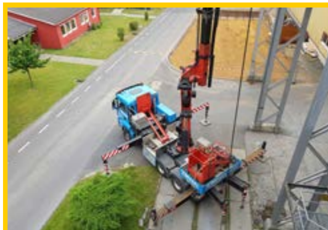
Hier werden alle benötigten Arbeitsgeräte mit einem Autokran auf die Plattform Ebene gehoben.
