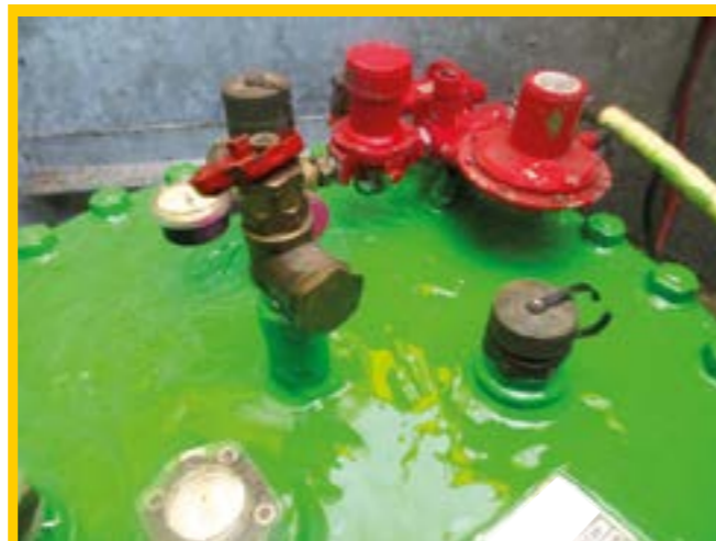
Auch die Bearbeitung von Schadstellen an Mannlochdeckeln ist möglich.
