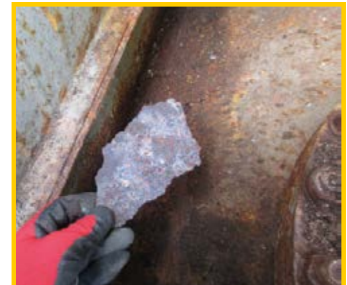
Werden Instandsetzungsmaßnahmen auf die lange Bank geschoben, kann die ungehindert fortschreitende Korrosion bis hin zum Werkstoffabtrag führen.
